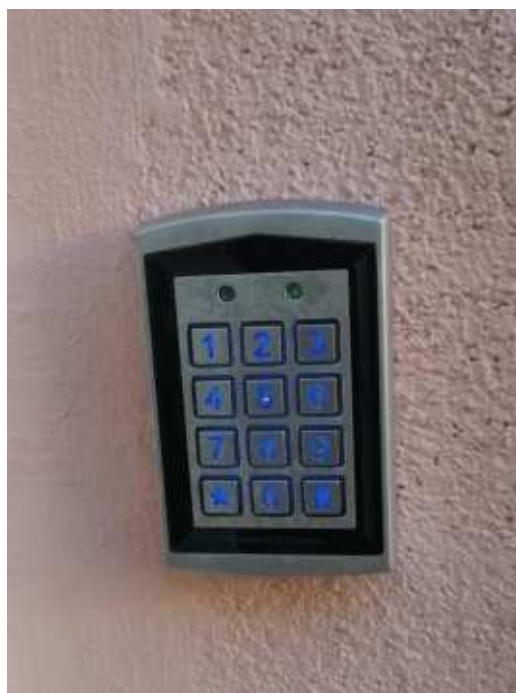
Instalace alarmu v MŠ Žižkova
